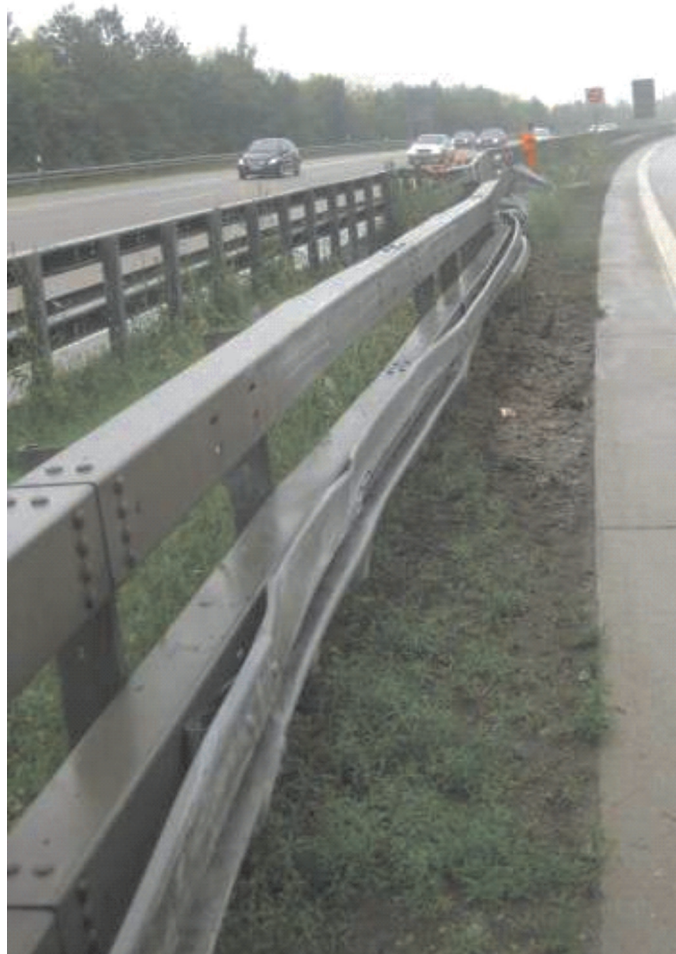
SUPER-RAIL nach extremem Anprall (Unfallstelle wurde innerhalb von 24 Std. repariert!)
